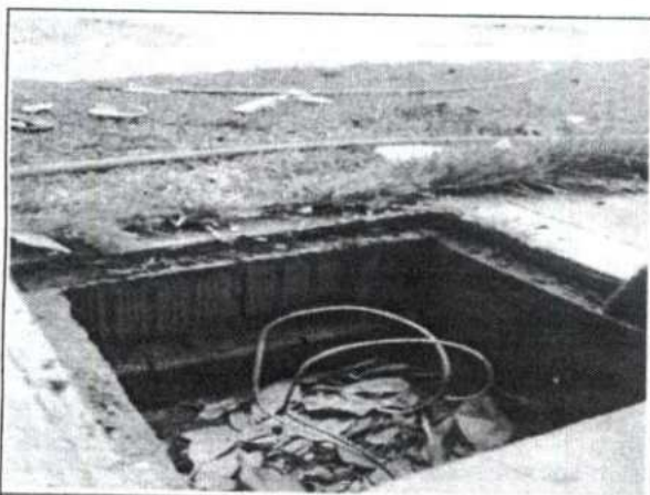
FOTO Nº INSTALAÇÕES ELÉTRICAS 15 JANEIRO 2024
