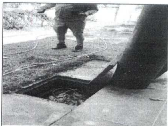
FOTO Nº INSTALAÇÕES ELÉTRICAS 16 JANEIRO 2024
