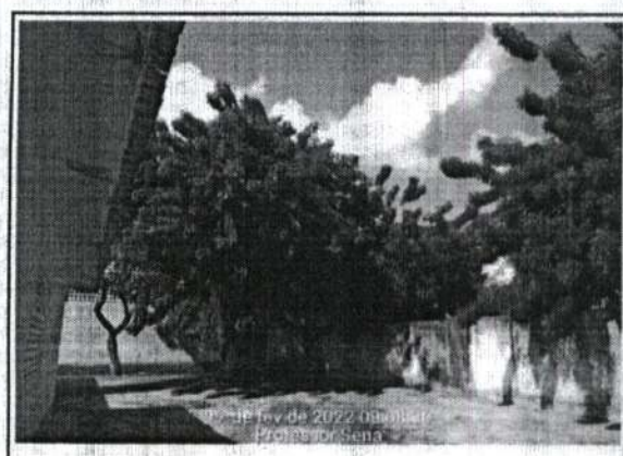
FOTO Nº ÁRVORES DANIFICANDO CALÇADAS E MUROS 7
