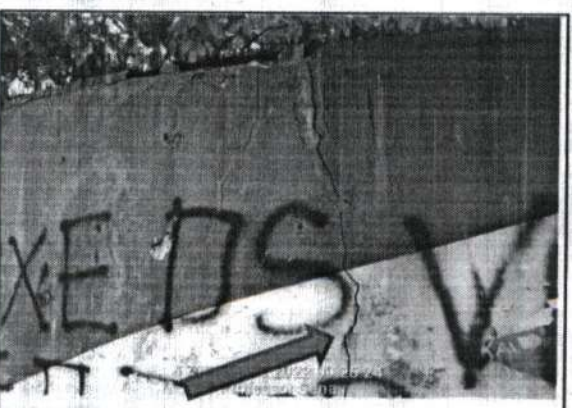
FOTO Nº FISSURAS EM ALVENARIA 11
