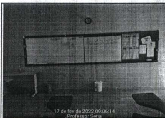
FOTO Nº NECESSIDADE DE REVESTIMENTO CERÂMICO DE PAREDE SALAS DE AULA E SALAS ADMINISTRATIVAS
