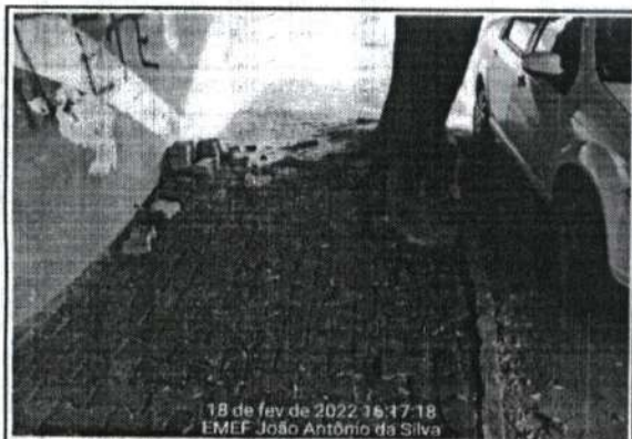
FOTO Nº ÁRVORES DANIFICANDO CALÇADAS 5
