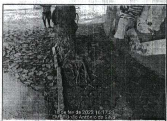
FOTO Nº ÁRVORES DANIFICANDO CALÇADAS 4
