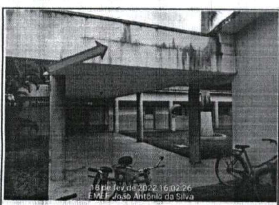
FOTO Nº FISSURAS EM ALVENARIA 9
