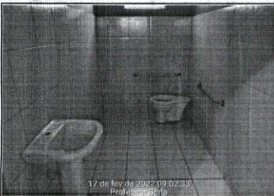
FOTO Nº 57 NECESSIDADE DE TORNEIRAS E TAMPAS DE VASO E CAIXA ACOPLADAS
